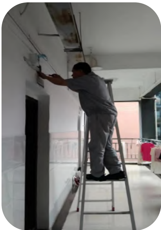
宿舍楼电源故障检查
