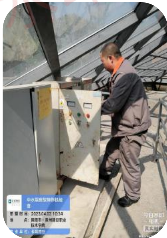
中水泵故障停泵处理
