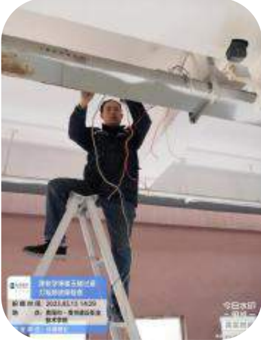
F1 五楼过道线路故障检查
